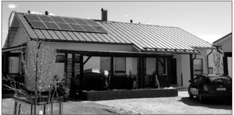
Aurinkopaneelit asennettuna omakotitalon katolle
